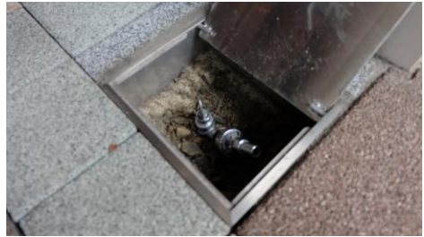
散水栓（蓋を開けた状態）
