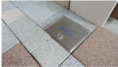
散水栓（蓋を閉めた状態）
