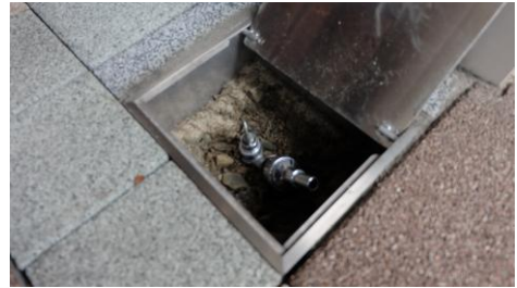
散水栓（蓋を開けた状態）
